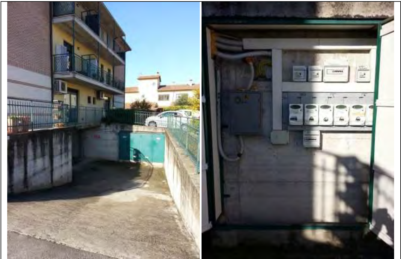
Foto 29-30 – Contatori elettrici posti lungo la rampa condominiale di accesso al piano interrato dell'edificio.
