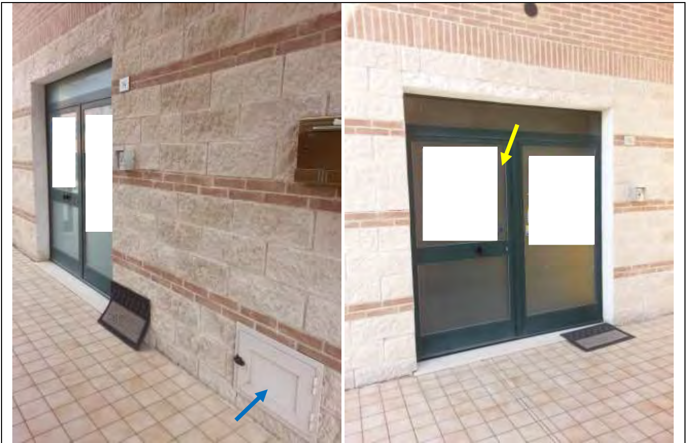
Foto 9-10 – Particolare dell'ingresso lato interno. In BLU la posizione del contatore dell'acqua.
