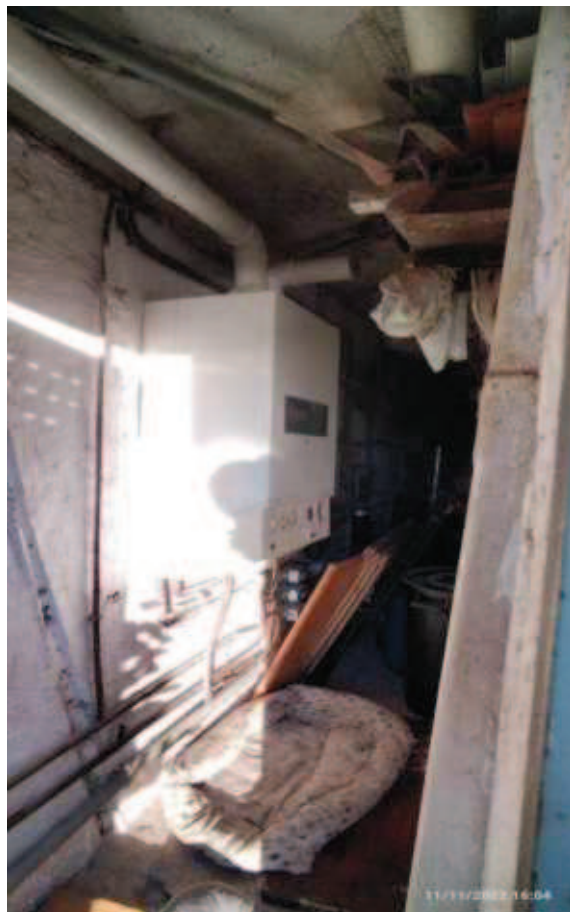
Sottoscala – Locale Caldaia
