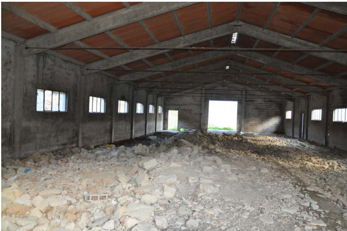
FOTO 34 FABBRICATO “STALLA” (descritto al punto 4, situato nella zona ad alto rischio di dissesto idrogeologico)
