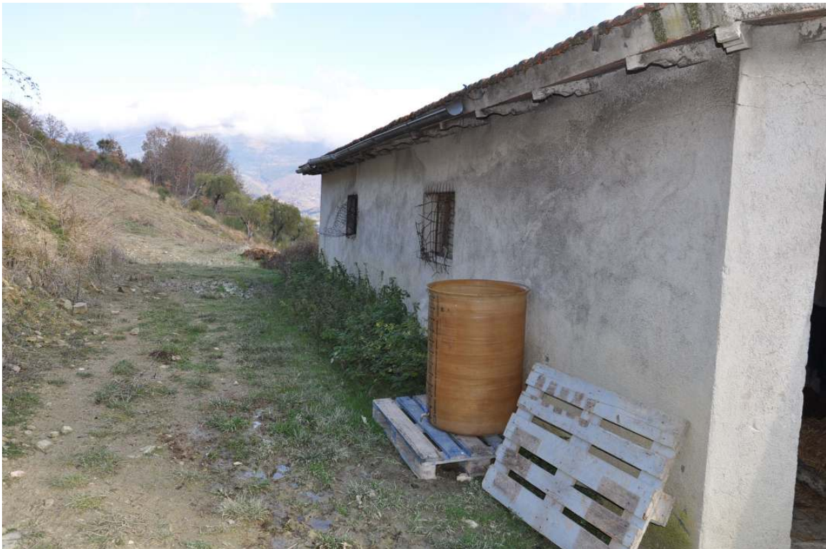
FOTO 30 FABBRICATO “STALLA” (descritto al punto 4, situato nella zona ad alto rischio di dissesto idrogeologico)
