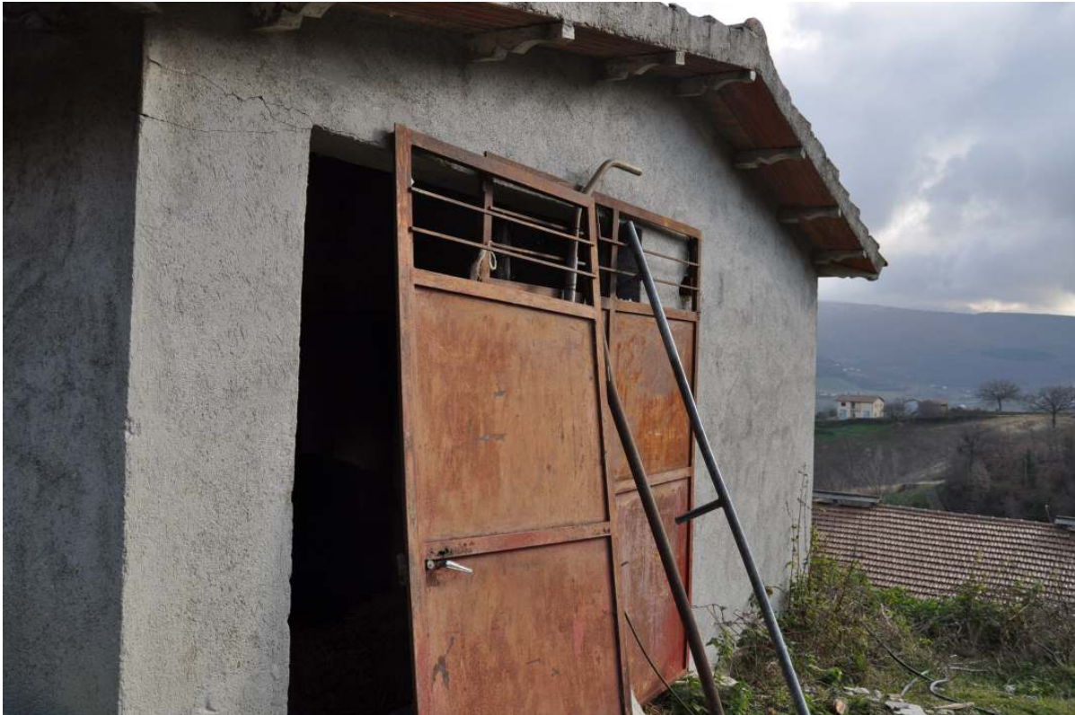
FOTO 29 FABBRICATO “STALLA” (descritto al punto 4, situato nella zona ad alto rischio di dissesto idrogeologico)
