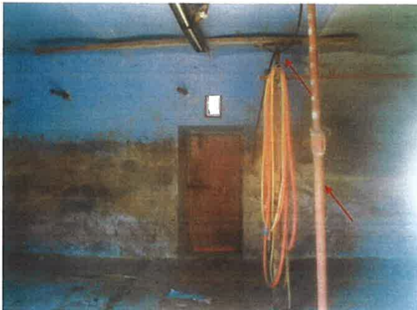
Foto n° 9: interno del locale stalla al piano Terra ( in evidenza i pontelli sul solaio )
