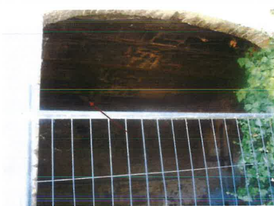
Foto n° 14: interno del locale stalla al piano Terra ( si evidenzia il solaio parzialmente crollato )
