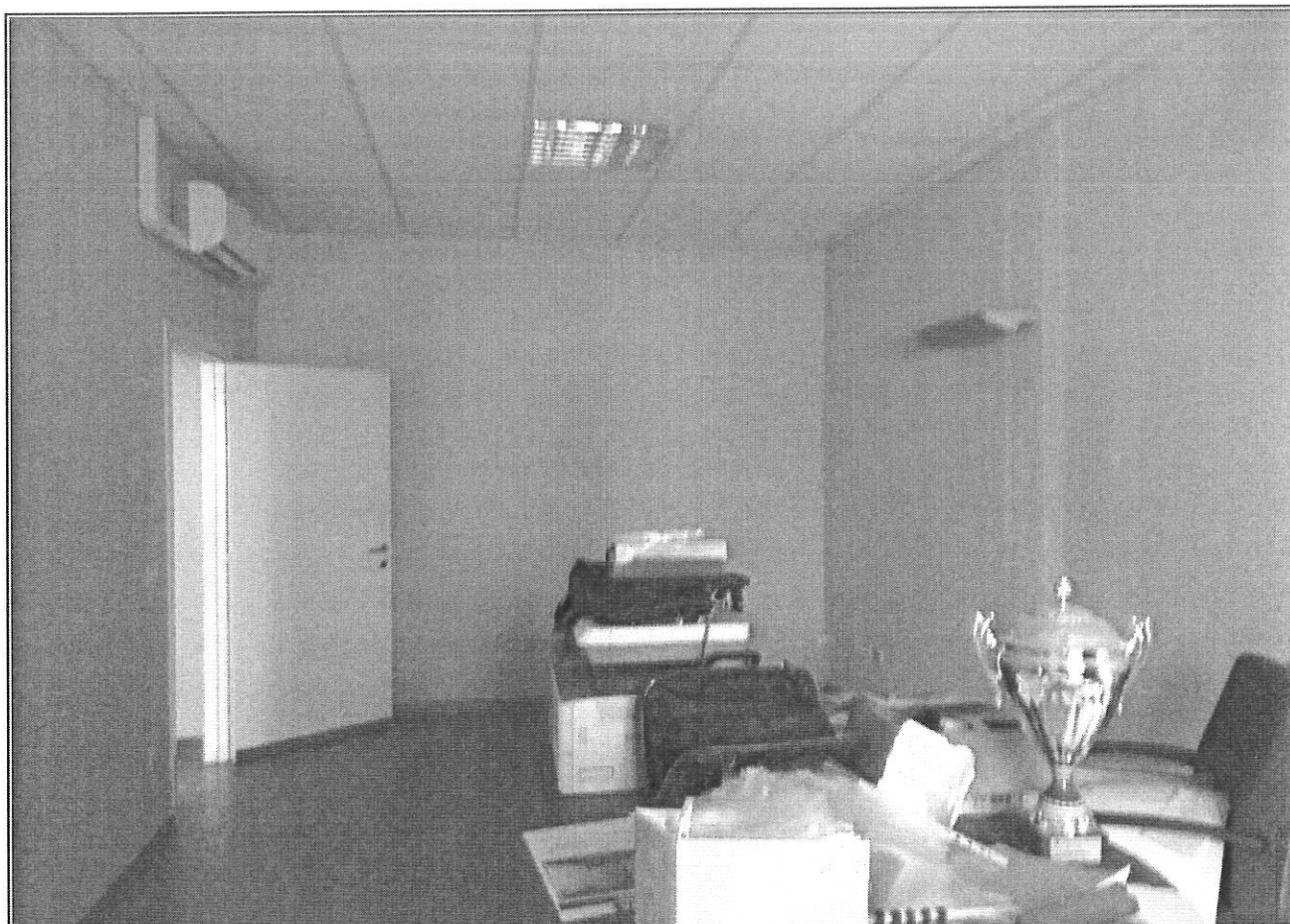
Fig. 9 – Altro ufficio. L'impianto di riscaldamento è stato rimosso e sostituito da convettori elettrici.
