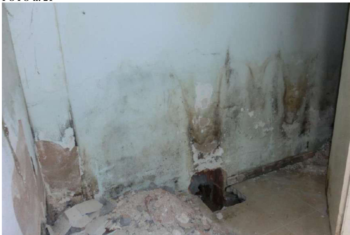
Interno camera matrimoniale – area infiltrazioni acqua
