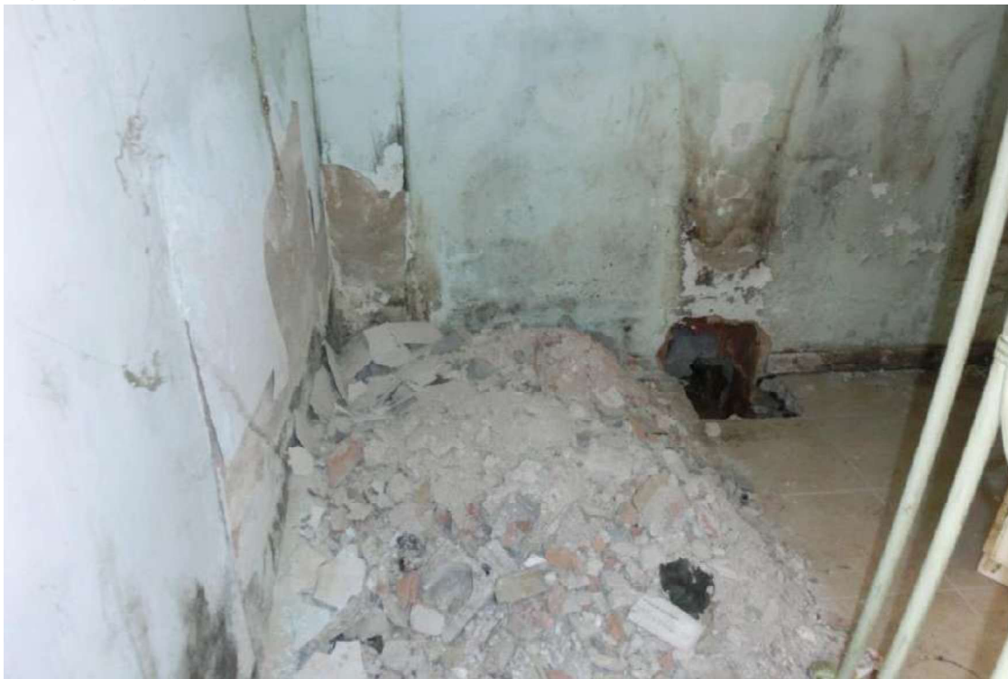
Interno camera matrimoniale – area infiltrazioni acqua
