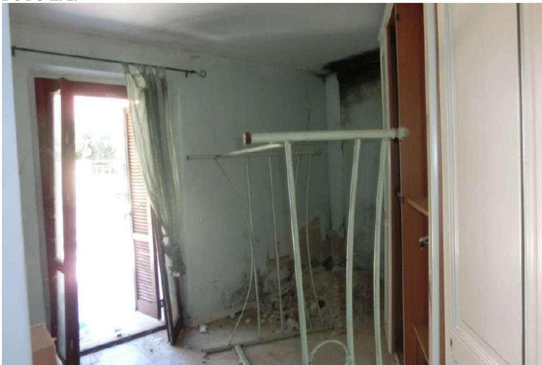
Interno camera matrimoniale – area infiltrazioni acqua
