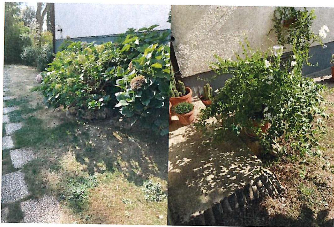
Foto 25 e 26 alloggiamenti fosse Imhoff
