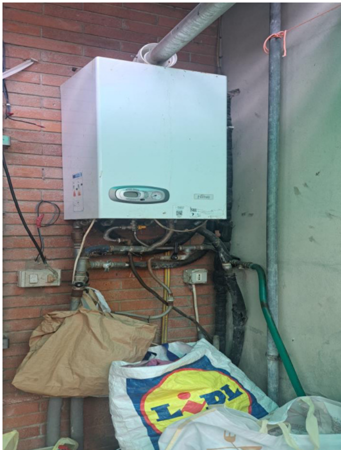
Caldaia Esterna Fabbricato
